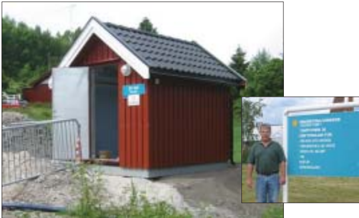
Nytt overbygg fra ITT Flygt AS underleverandør Kafra, men nede i sumpen ble de gamle Flygt-pumpene beholdt. Innfelt: Oppsynsmann Gunstein Eilertsen
